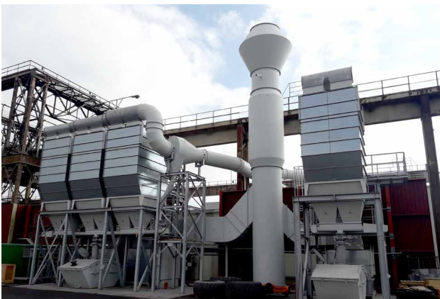
Neue Absaugung und Entstaubungsanlage im Fallwerk
