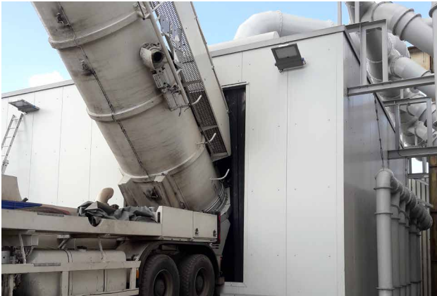
Neue Einhausung für Kippprozess Saugfahrzeuge/Kehrmaschinen
