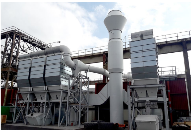
Neue Absaugung und Entstaubungsanlage im Fallwerk
