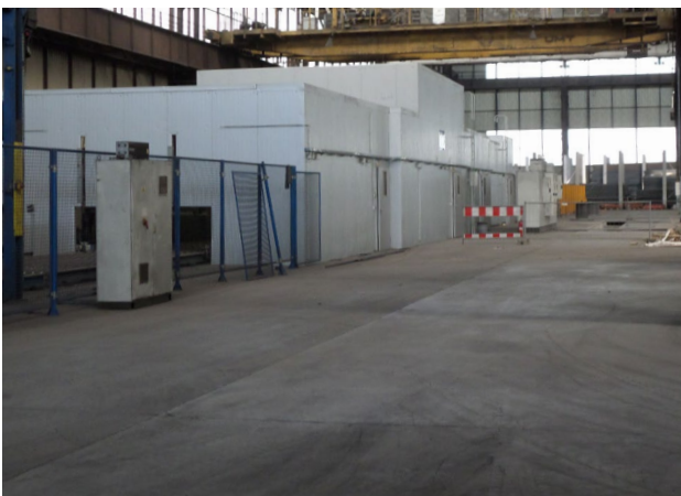
Kapselung Mattenschweißmaschine, Mattenhalle (seit 2015)
