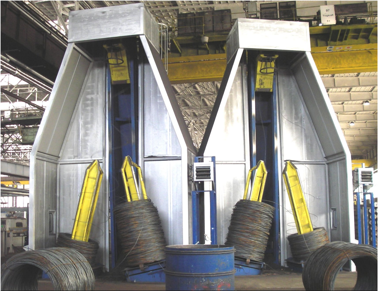
Walzdrahtablauf der TEUREMA-Reckanlagen mit realisierten Schallschutzmaßnahmen
