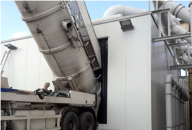
Neue Einhausung für Kippprozess Saugfahrzeuge / Kehrmaschinen
